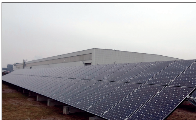
System PV w Żarowie o mocy 220,84 kWp
