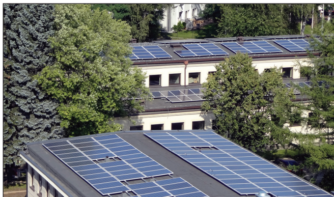
System PV w Łodzi o mocy 450 kWp
