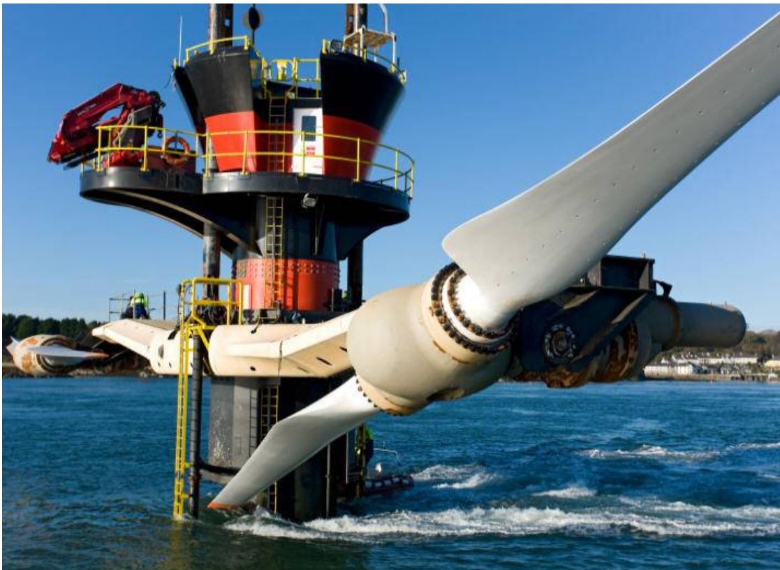
Fot. Pojedyncza wieża elektrowni pływowej z turbina SeaGen firmy Siemens o mocy 1,2 MW
