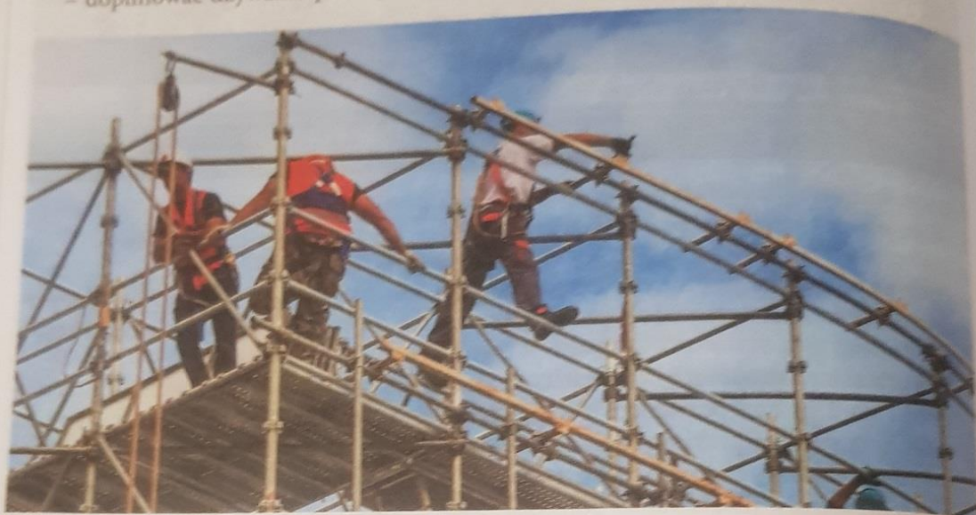
Rys. 3.39. Zabezpieczenie pracownika podczas wykonywania prac na wysokości
